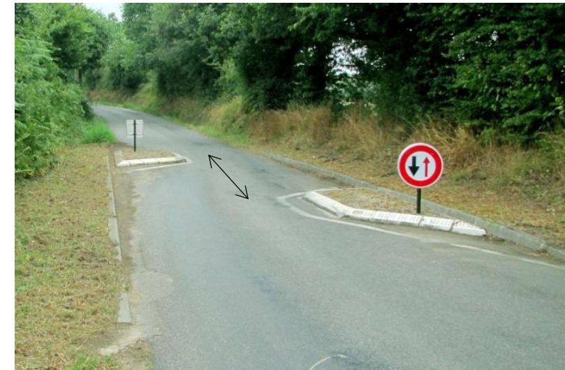
Exemple d'une écluse avec environnement végétalisé
